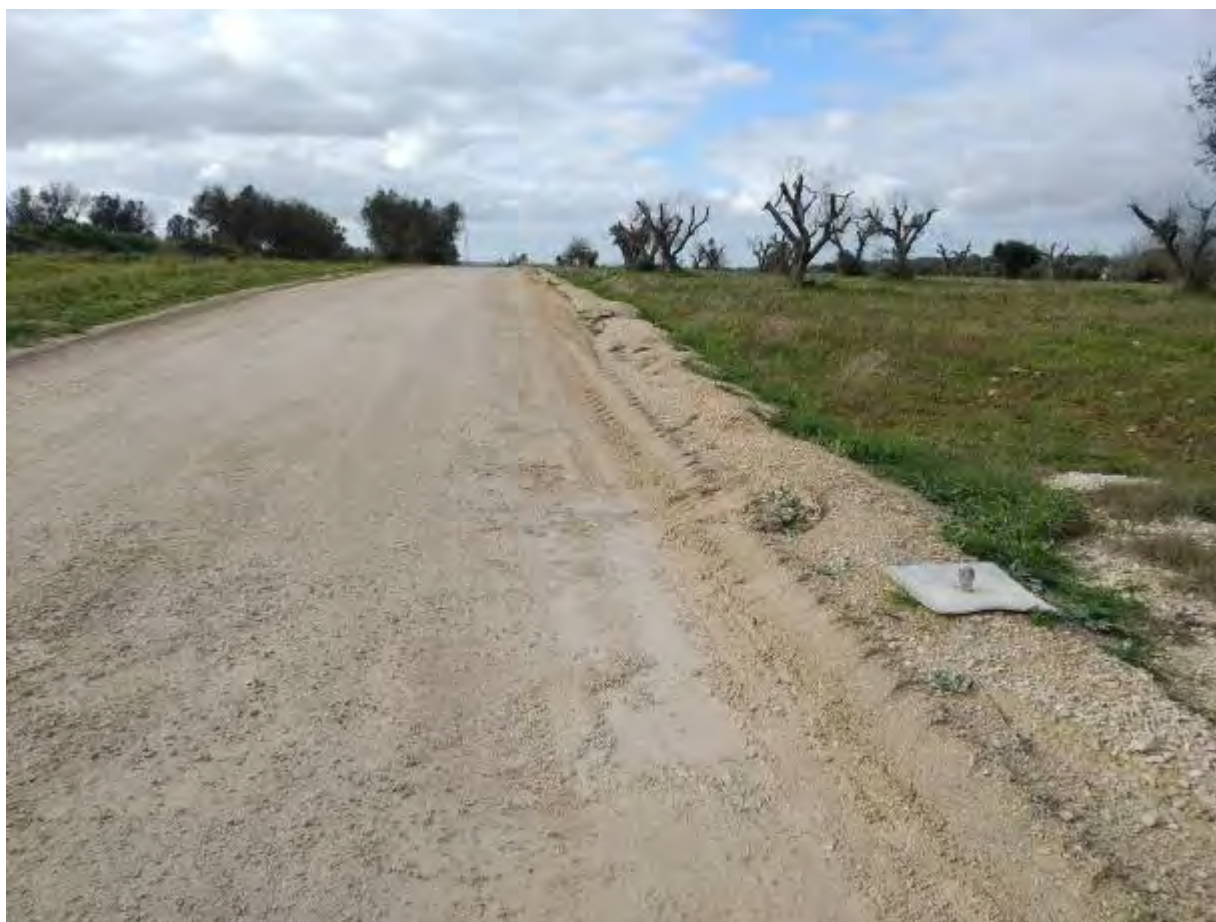
Foto 4.7 – Linea di abbattimento polveri con pop-up lungo la viabilità di accesso e di servizio.
