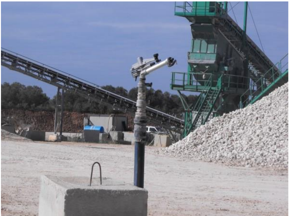
Foto 19 – Particolare di un irrigatore a lunga gittata utilizzato per l'abbattimento delle polveri prodotte sul piazzale
