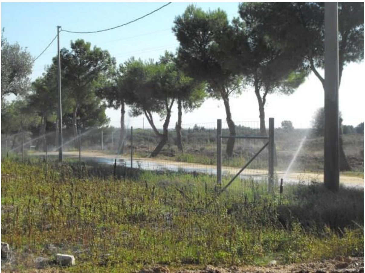
Foto 6 – l'impianto di abbattimento polveri dislocato lungo il viale di accesso all'area di cava
