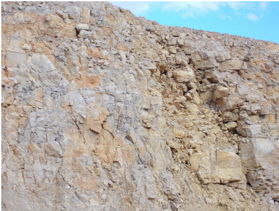
Foto 3 – Parete di altezza 13 m, localmente molto fratturata, con blocchi instabili da disgiungere
